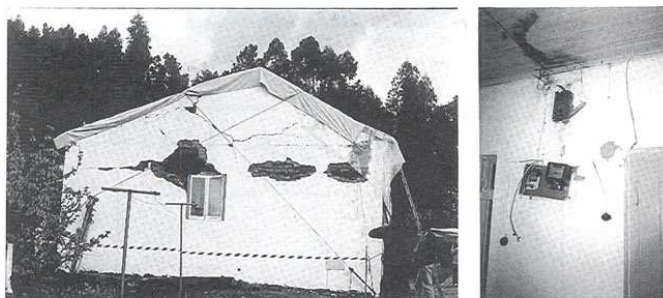
Fig. 2: Daños causados por un rayo que impactó en la antena TV (Marzo de 2002, Limeiras, Portugal)
